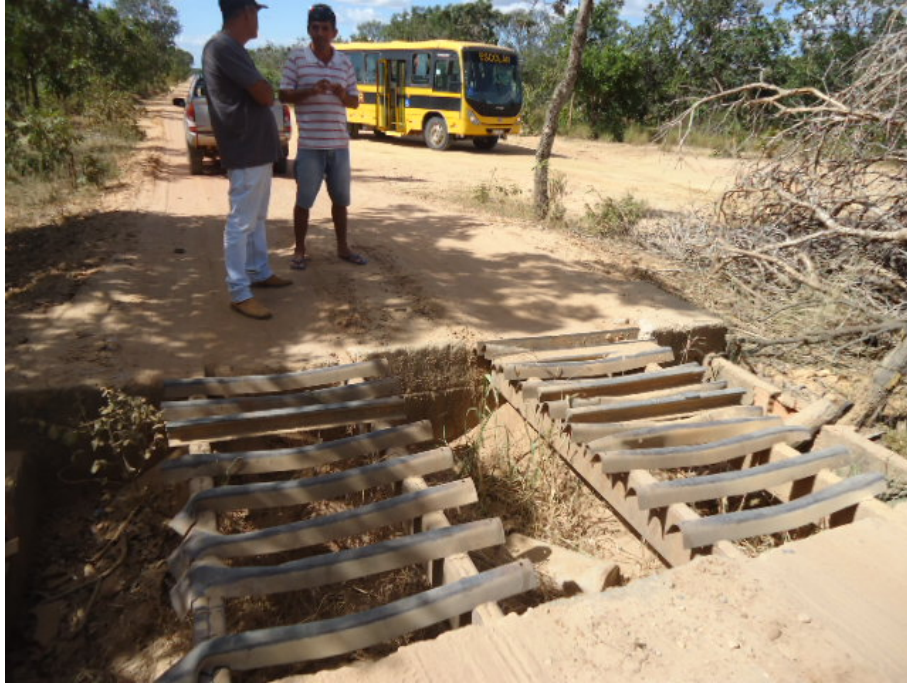
Figura 15: Mata-Burro Estrada São Romão/Santa Fé (Srº José Luiz). Coordenadas: S16°28'03.4 - W45°21'19.2
