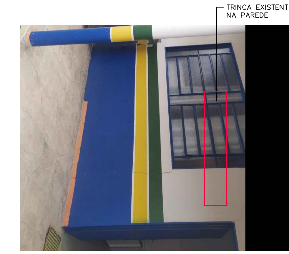
8 FOTO 01 - DETALHE TRINCA NA PAREDE S/ESCALA
