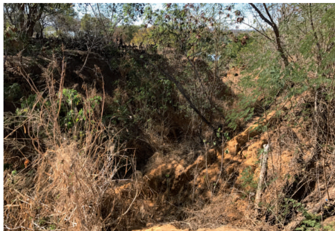
Figura 52 – Erosão junto ao Rio São Francisco em São Romão. Fonte: GESOIS, 2017.
