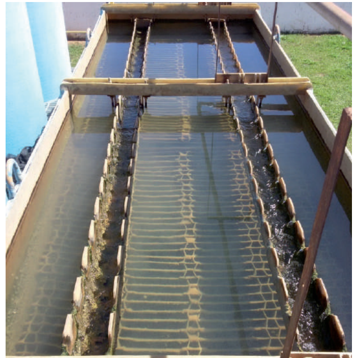
Figura 34 – Flocculadores Fonte: GESOIS, 2017
