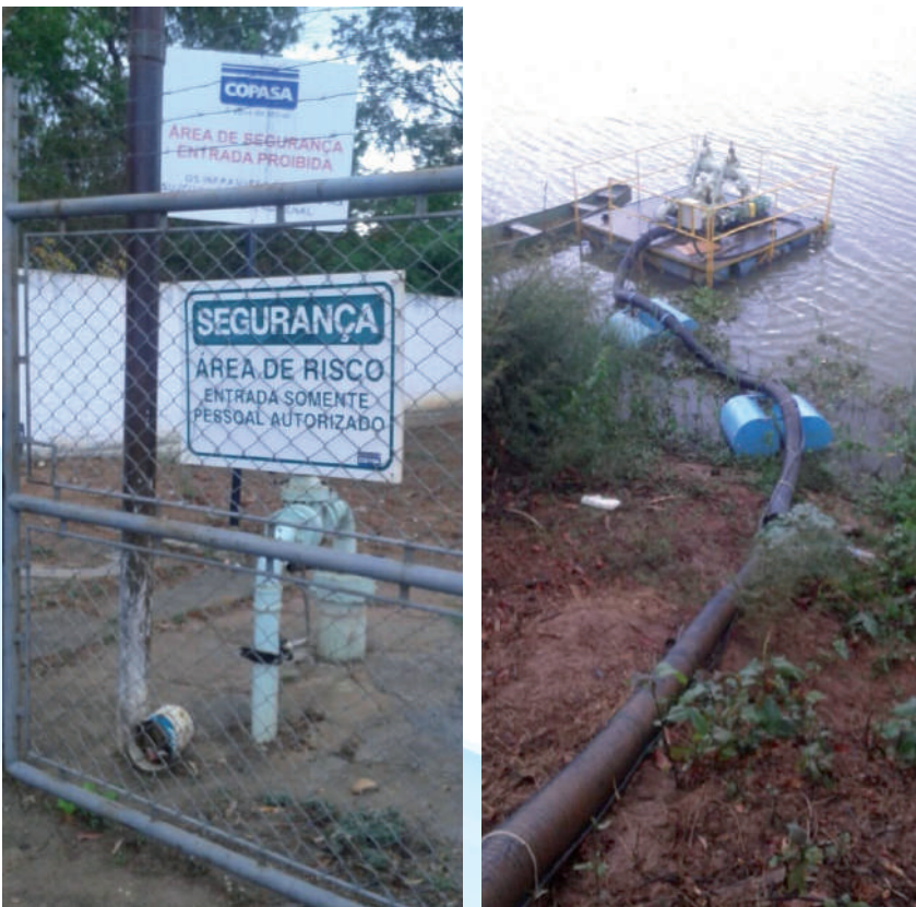
Figura 32 – Captação Rio São Francisco em São Romão Fonte: GESOIS, 2017
