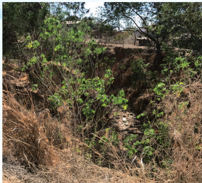
Figura 53 – Erosão junto ao Rio São Francisco em São Romão Fonte: GESOIS, 2017
