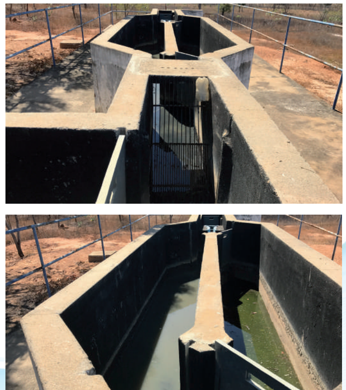
Figura 42 – Tratamento Primário (Canal de Chegada e Calha Parshall) em São Romão Fonte: GESOIS, 2017
