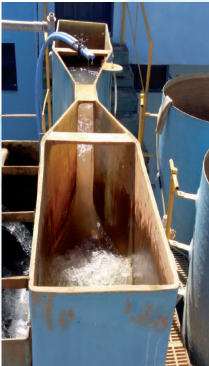
Figura 33 – Calha Parshall Fonte: GESOIS, 2017
