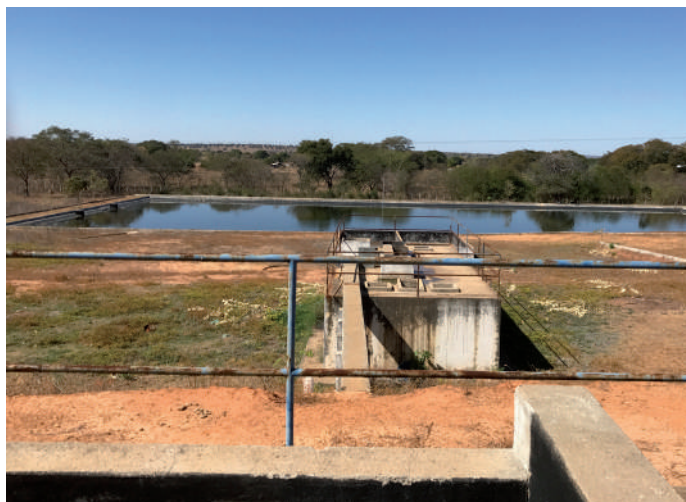
Figura 44 – Lagoa de Tratamento Facultativa em São Romão Fonte: GESOIS, 2017
