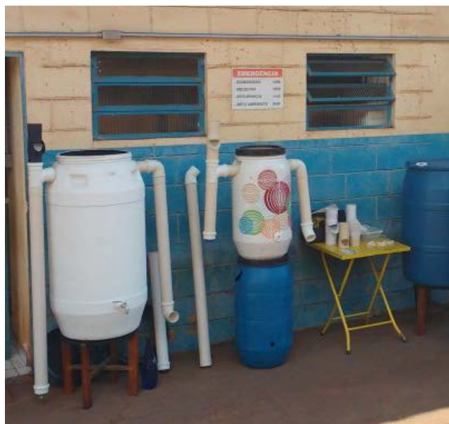
Figura 23 – Captação de Água de Chuva – Social Fonte: GERASOL, 2018
