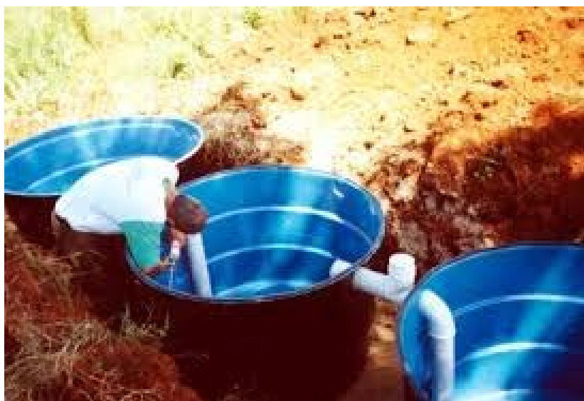
Figura 29 – Fossa Séptica Fonte: EMATER, 2014
