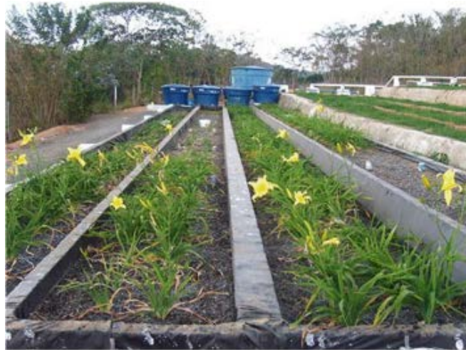
Figura 30 – Tratamento de Esgoto Sanitário em Sistemas Alagados Construídos Cultivados com Lírio Amarelo
